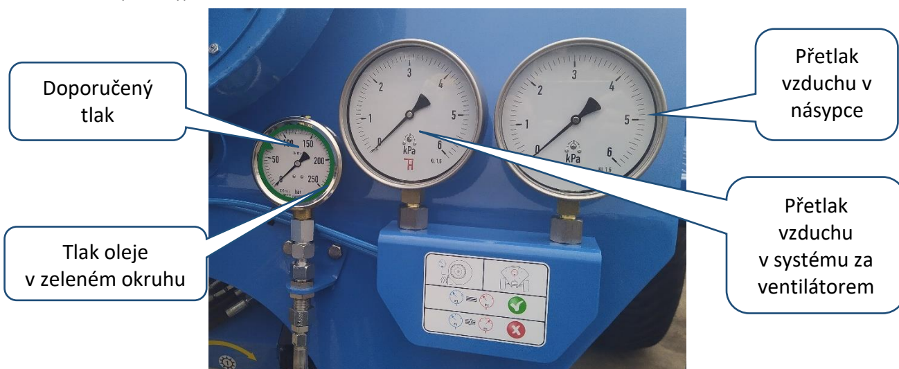
Obr. 14 - Tlakoměry na násypce
